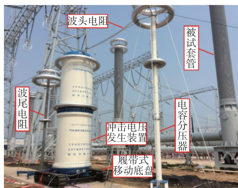
图5 1000 kV 南京站现场应用
