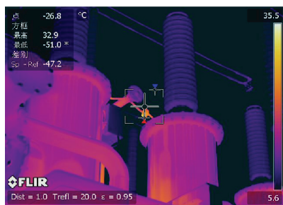
图5 1号主变调补变A相局部热像图
