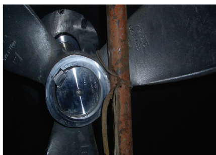
图7 运行后失效的脱硫搅拌器转子
