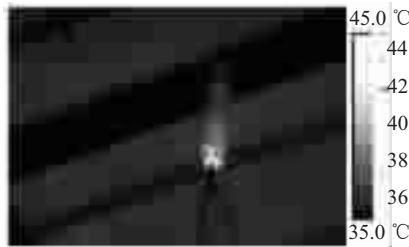
图 9 220 kV 母线悬挂绝缘子
