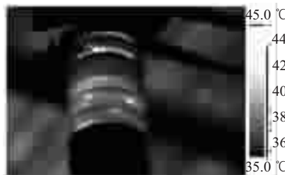
图 10 某刀闸 A 相支柱绝缘子
