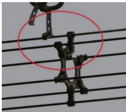
图 2 某 500 kV 线路与防舞装置相连的间隔棒框板撕裂
