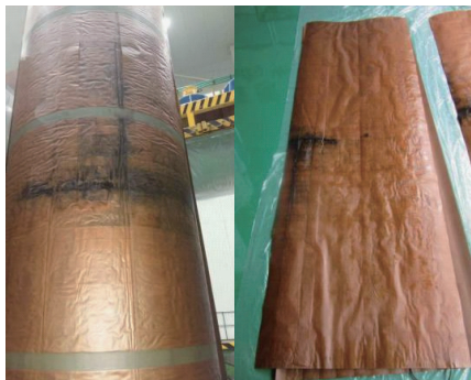
图 9 某 1000 kV 电抗器解体发现缺陷部位 Fig.9 Defects positions of a 1000 kV reactor
